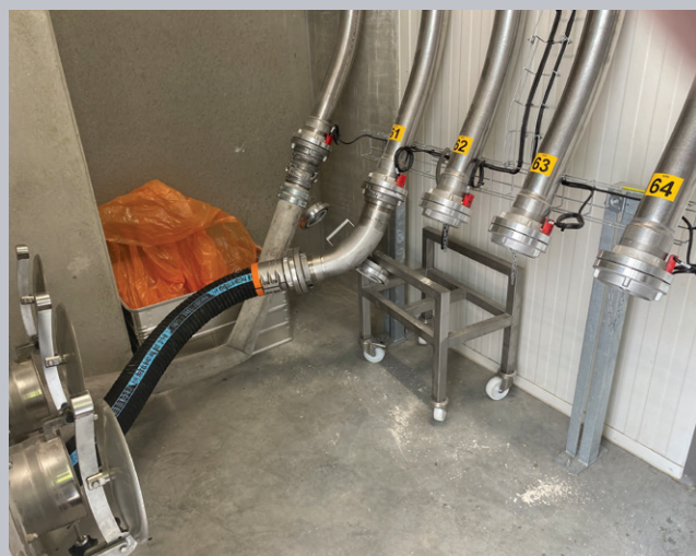
Gericke Mobile Pulse-Flow™ Transportband naar silo pijpleidingen
