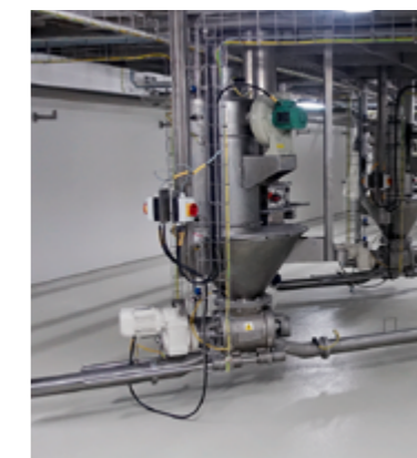
Transporte fase diluída
